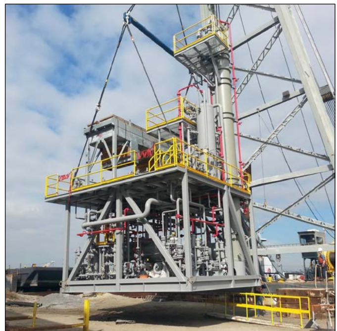
Condensate Stabilizer Skid
